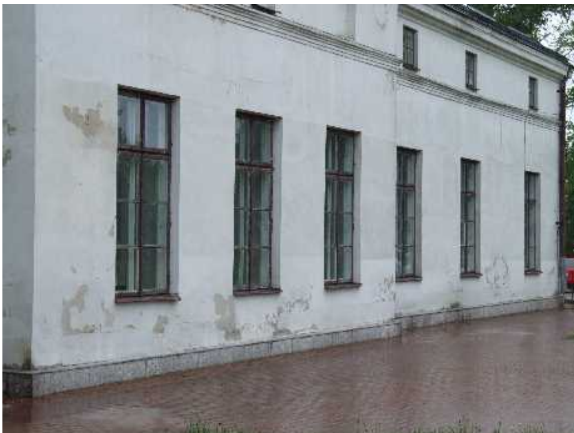
Zdegradowana elewacja pałacu
